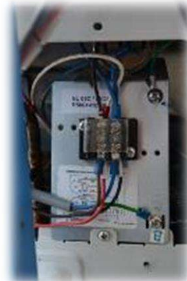
Rajah 7: Panel thermometer yang dipasang pada indoor unit
